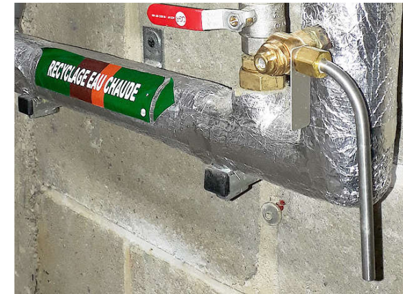
Recyclage ECS général (point accessible et flambable)
