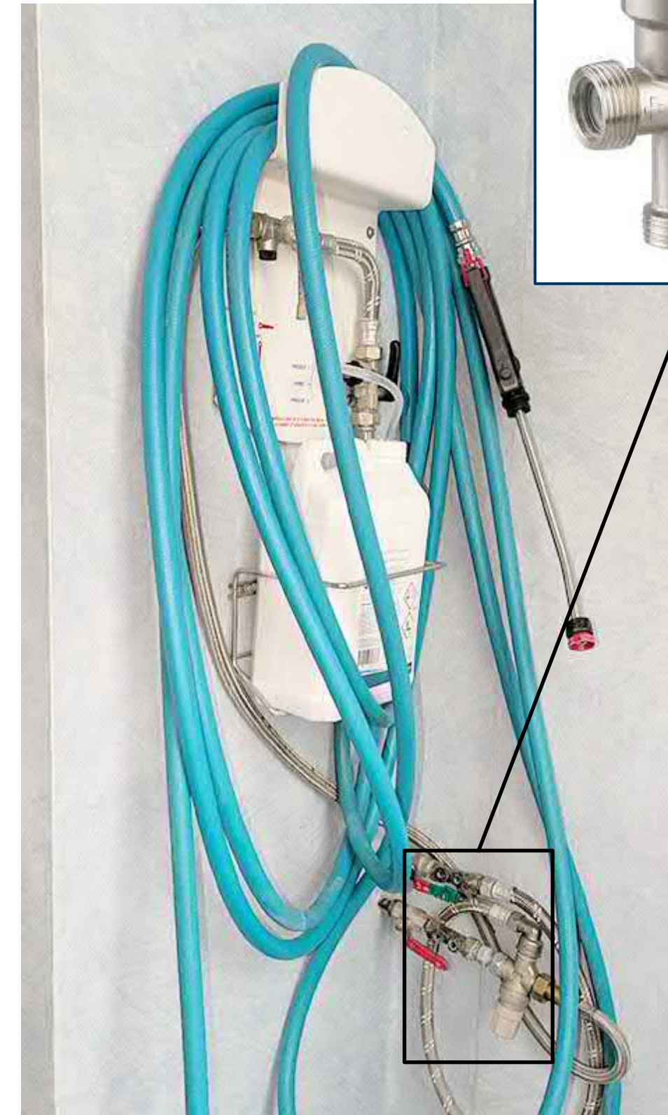
Centrale de désinfection sur mitigeur thermostatique
