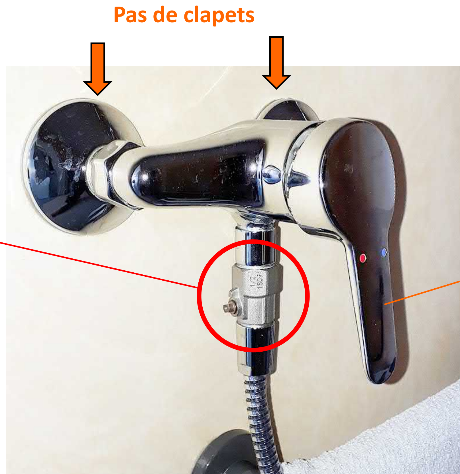
Vanne d'arrêt fermée (poignée ôtée pour empêcher tout puisage intempestif)
